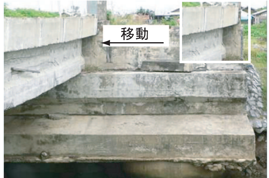
写真：桁の移動 (出典：幸左ら, 2010) 桁の損傷が軽微なまま支承が破壊
